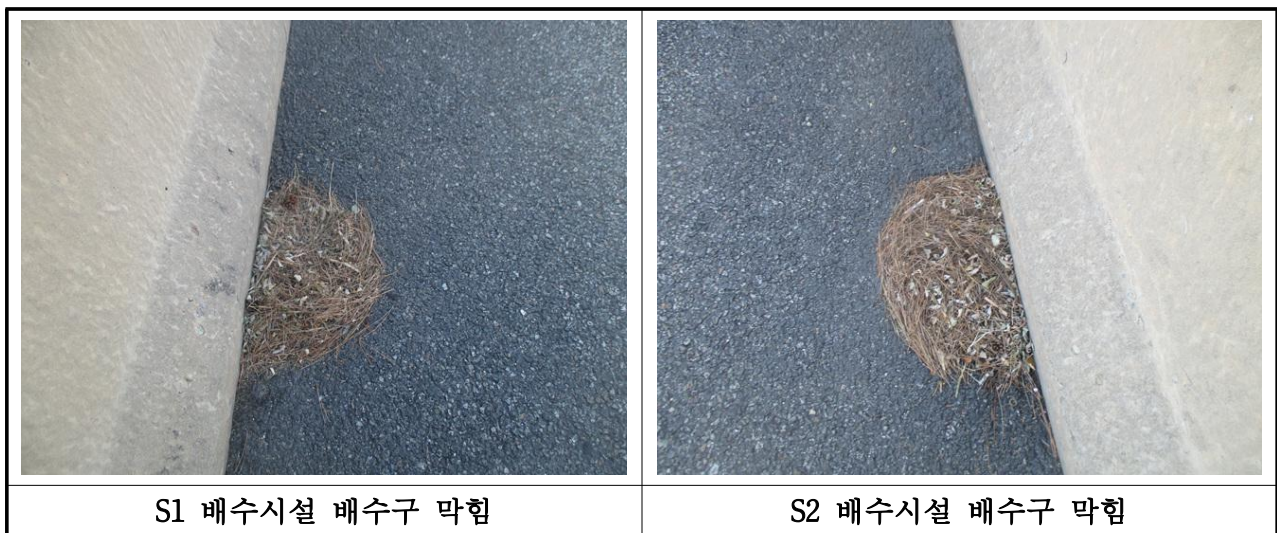
【사진 3.23】 배수시설 손상현황
