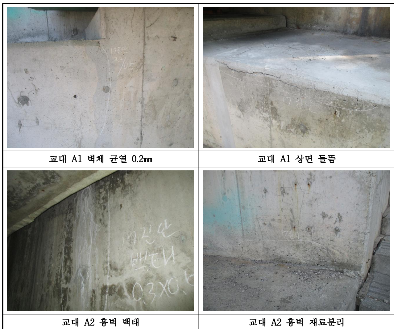
【사진 3.12】 교대 손상현황
