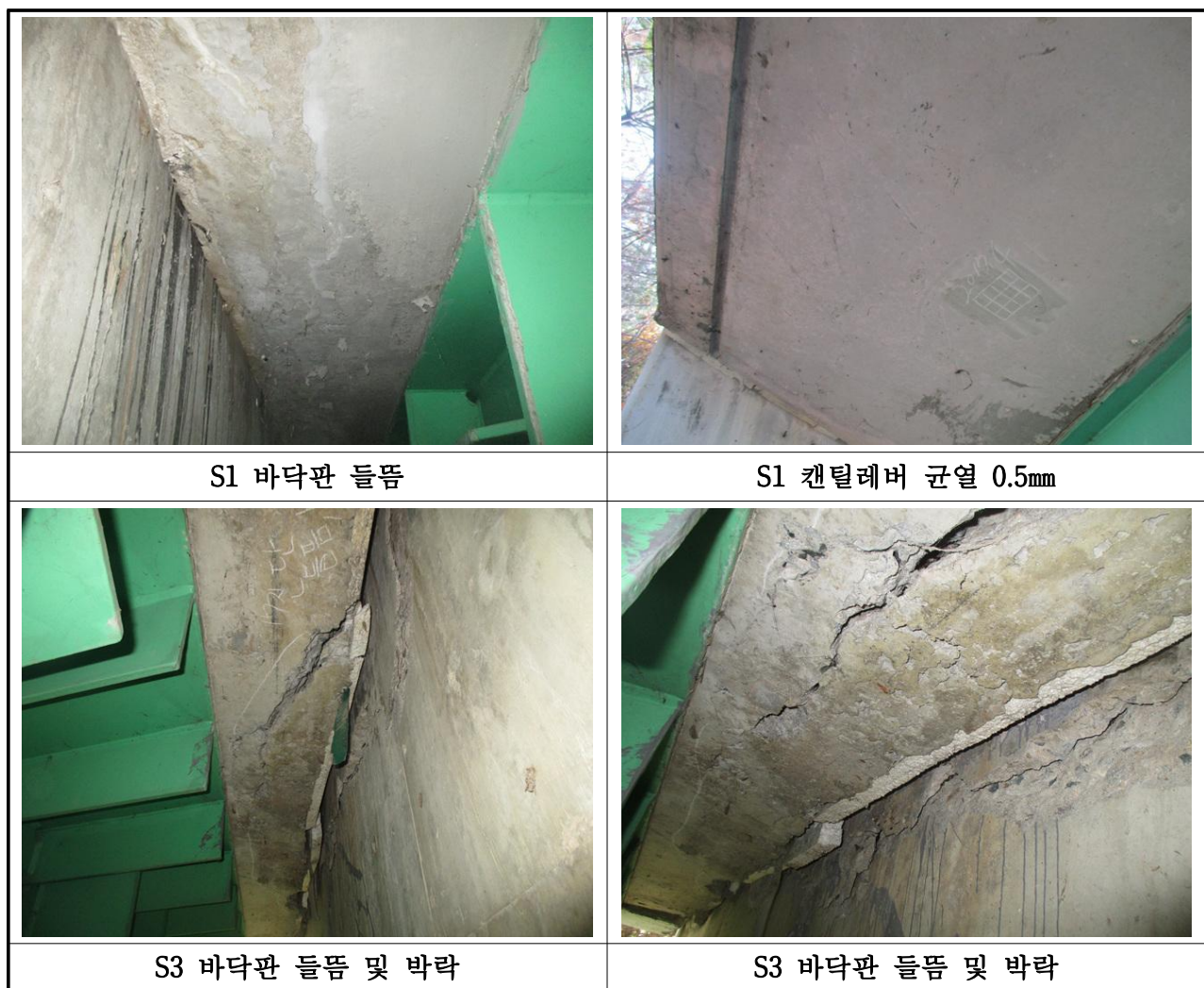
【사진 3.3】바닥판 손상현황
