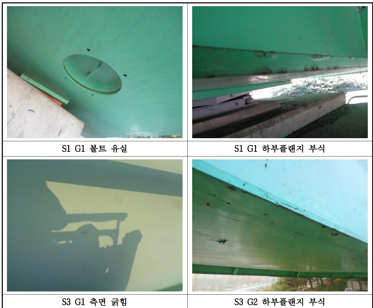
【사진 3.8】 강박스 거더 외부 손상현황
