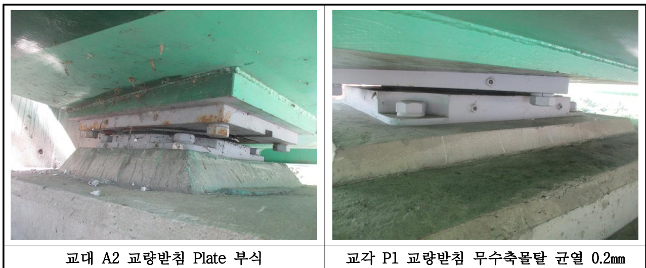
【사진 3.15】 교량받침 손상현황
