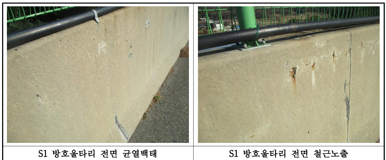
【사진 3.25】 난간 및 연석 손상현황
